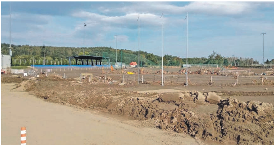
Zniszczony przez powódź niedawno wyremontowane zaplecze i stadion, na którym trenowali m. in. lekkoatleci z Juvenii. (foto: Juvenia Głucholązy)
