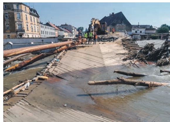
Powódź zniszczyła dotychczasową przeprawę na czas budowy nowego mostu
