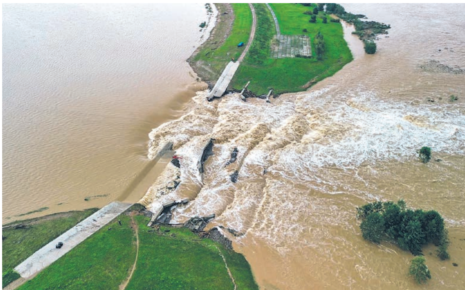
Przerwana zapora na zbioniku Topola
